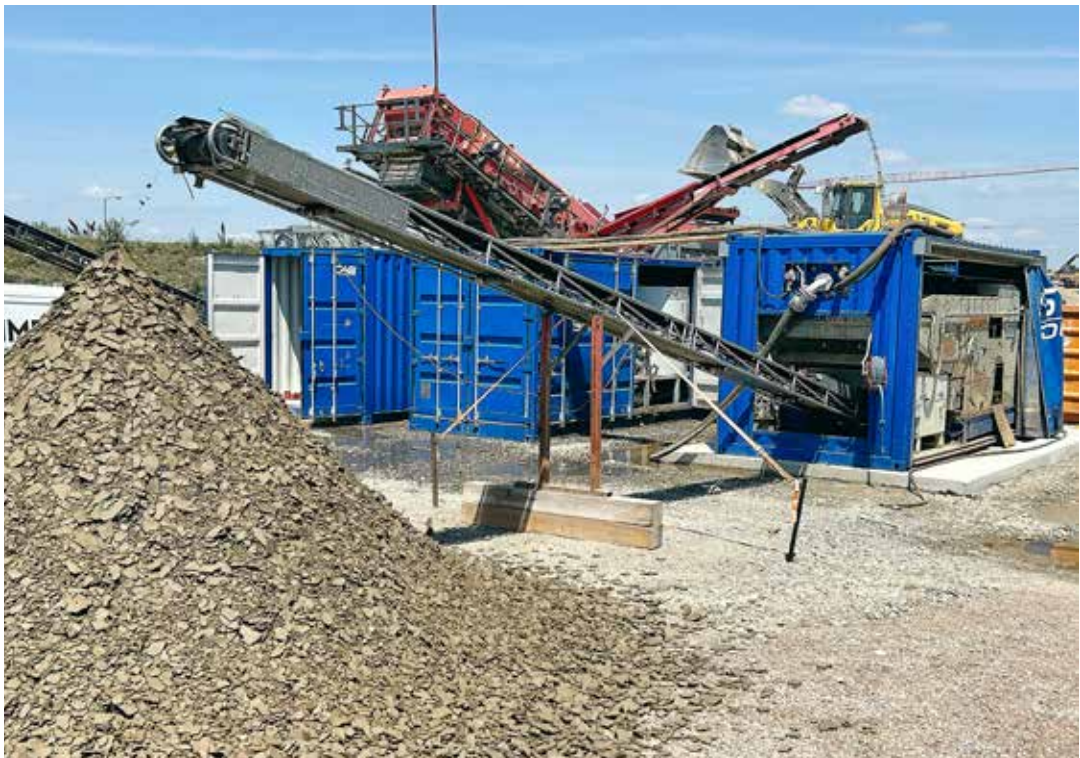
Austragung des entwässerten Schlammes und mögliche Wiederverwertung des Filterkuchens
